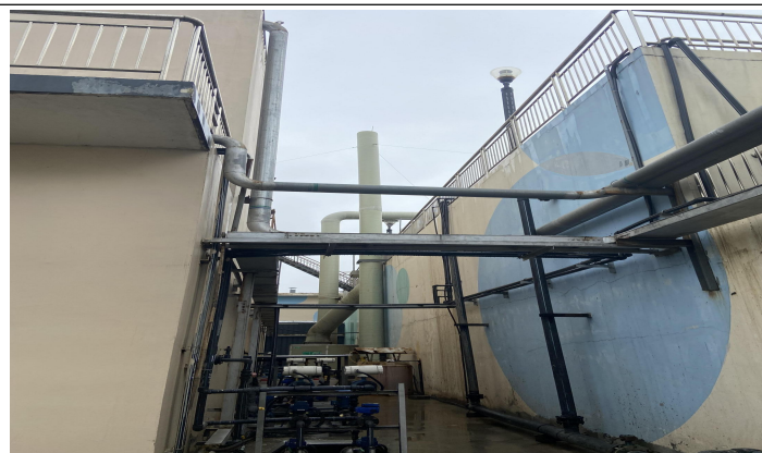
4#除臭系统 (DA004)
