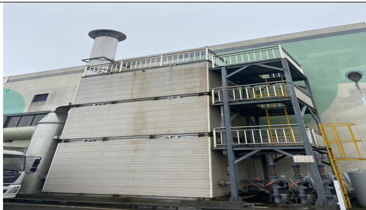
1#除臭系统 (DA003)
