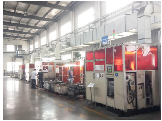
MAG 焊接设备废气收集方式
