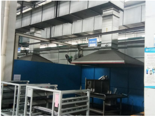
人工焊接设备废气收集方式
